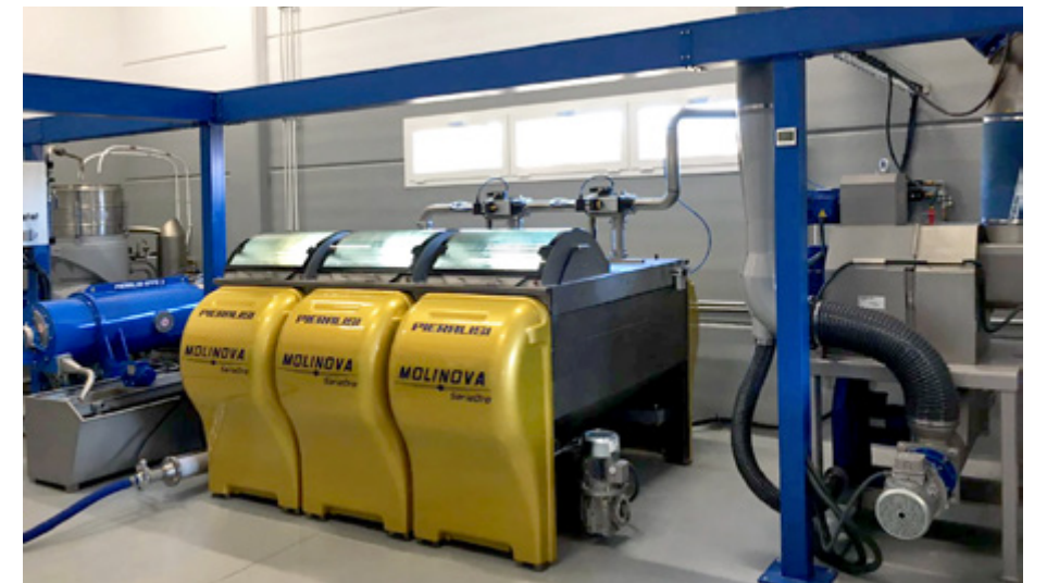
Instalaciones de la almazara
