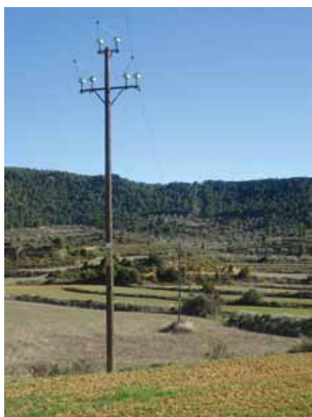
Línea con postes de madera en Alloza.
